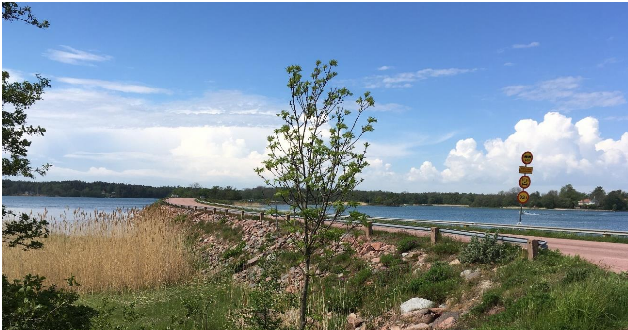
Figur 3. Järsövägen, på bank genom vatten. Foto taget från Skobboldsvägen, riktning norrut. Fotodatum 2022-06-03
