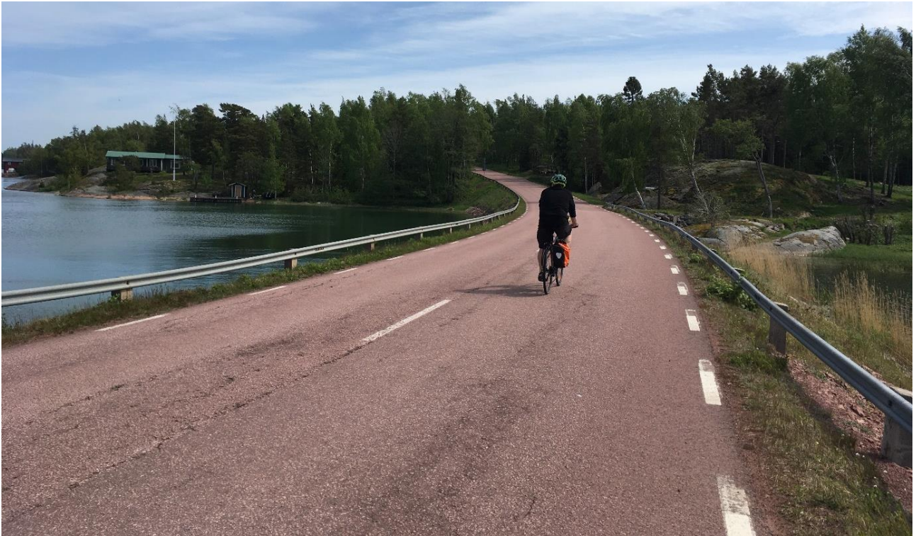
Figur 11. Exempel på beläggningsskador samt vägräcken längs Järsövägen. Fotot är taget vid Bergöbron i riktning söderut. Fotodatum 2022-06-03.
