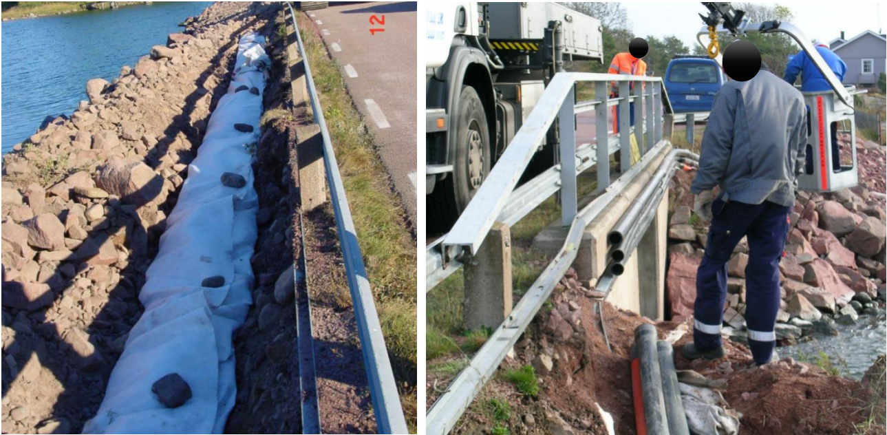
Figur 10. Till vänster: ledningsgrav i vägbank. Till höger: kabelskydd på bro nr 24 Skobholmsbron. Bildkälla: Mariehamns energi
