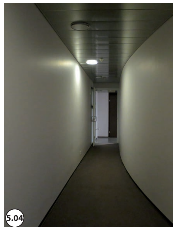
5.04 Dörr uppställd på magnet. Betjäningssyta saknas.
