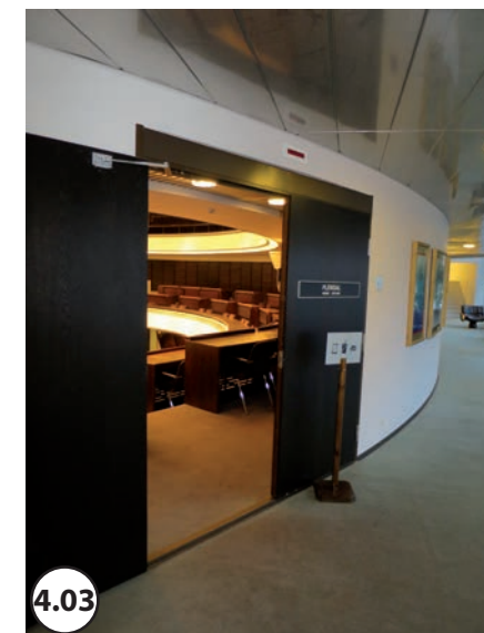
4.03 Pardörrar uppställda på magnet. Tröskel något hög.
