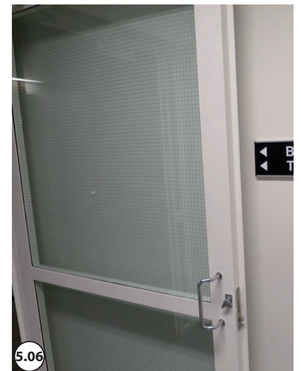
5.06 Utrymningsdörr uppställd på magnet.
